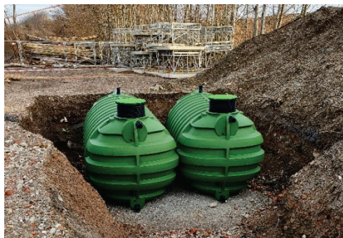
Kunststoffspeicher in Maribor
