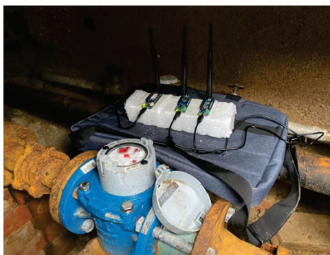
Wasserzähler im Universitätsgebäude in Split
